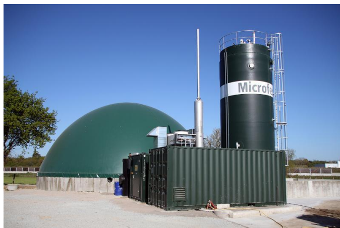
Figure 34. Photo de l'installation du GAEC des Buissons [75]
