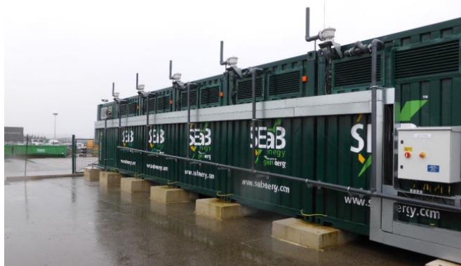
Figure 17. Photo du système Flexibuster™ installé sur le site de SEPUR [44]
